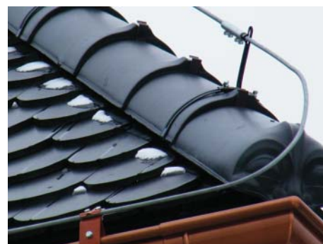
Токоотвод, смонтированный на коньке кровли с помощью конькового держателя
